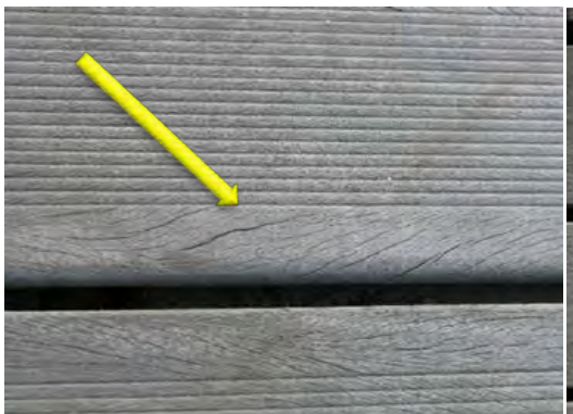
Cumaru med många små sprickor Foto från inspektionen i oktober 2018
