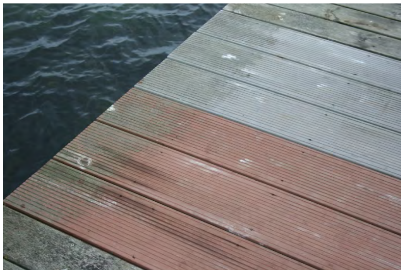
Figur 25. Påväxt i ytterkant av Green Plank grå och röd. Fläckar av fågellort som biter sig fast i rillor framträder också tydligt.
