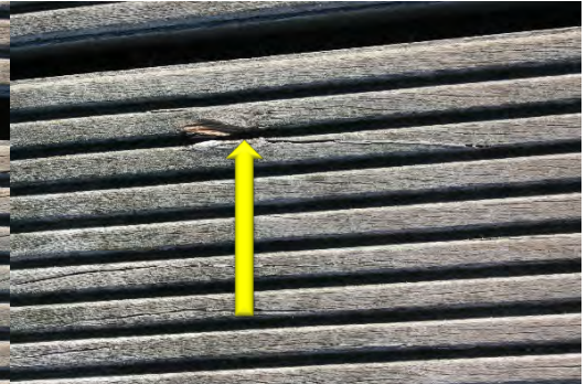
Kirai med större spricka i rilla Foto från inspektionen i oktober 2018
