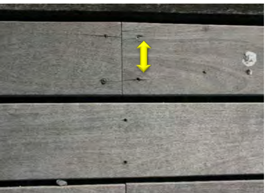
Ipé med sprickor kring skruvskallar Foto från inspektionen i oktober 2018
