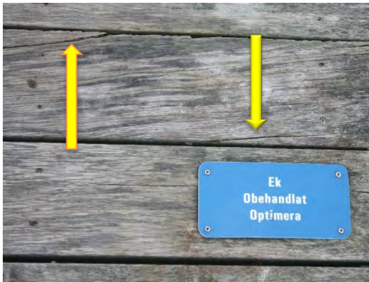
Ek med kantsprickor
