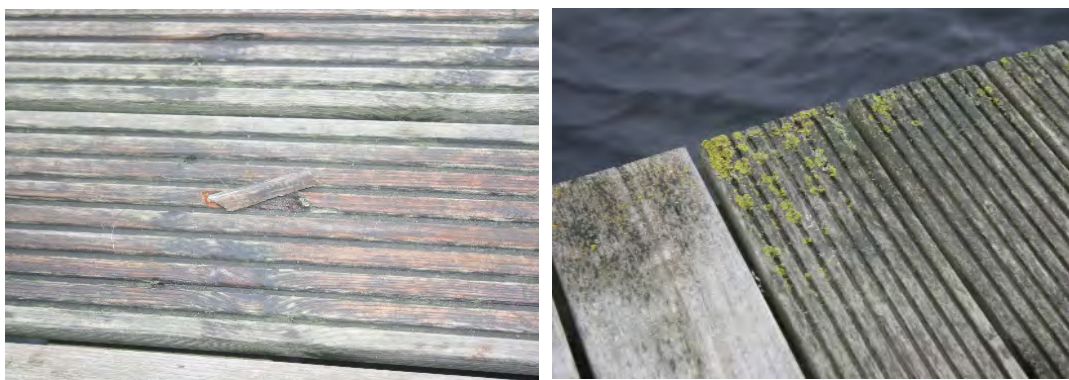
Figur 14. Thermowood: T v. sprucken rillning, t h. påväxt av lavar.
