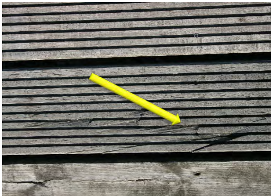
Azobé med sprickor och uppfläckning i rillor Foto från inspektionen i oktober 2018
